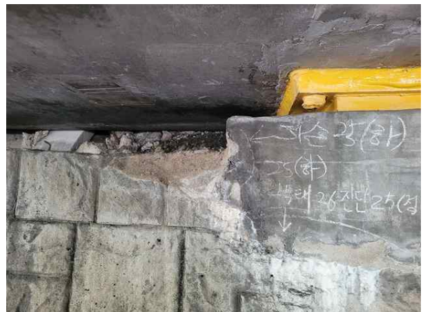
A1 구체 콘크리트 파손
