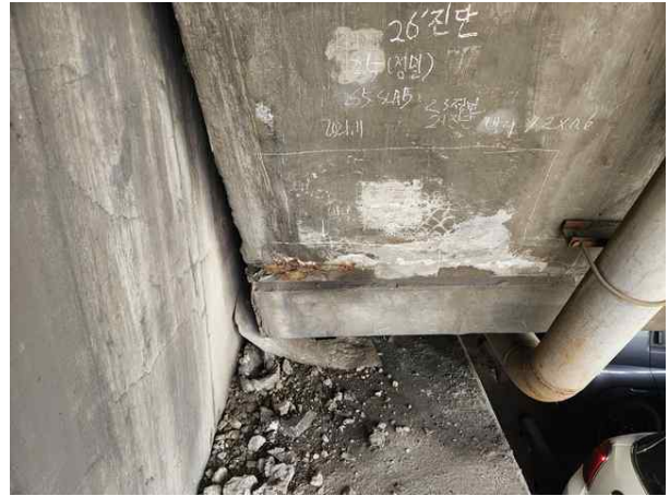
S5-A2 거더복부 박락 및 철근노출
