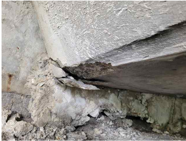
S1-A1 거더하면 콘크리트 박락
